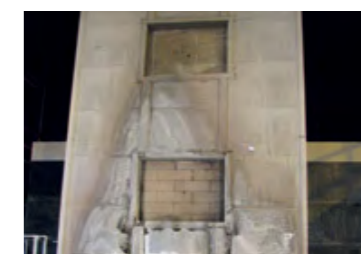
클래딩으로 인한 최소한의 화재 확산을 보여주는 테스트 후 외관
